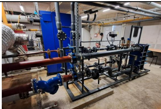
Sous-station La Motte-Servolex
